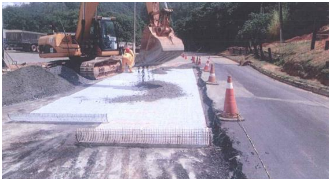
Figura 6.1927 Rota 116 – Reparos no Pavimento – Km 133+500
