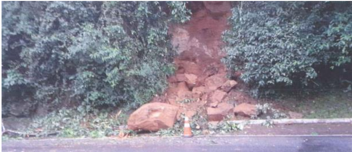
Figura 6.1321 Rota 116 – Queda de Barreira – Km 44+200 Sul
